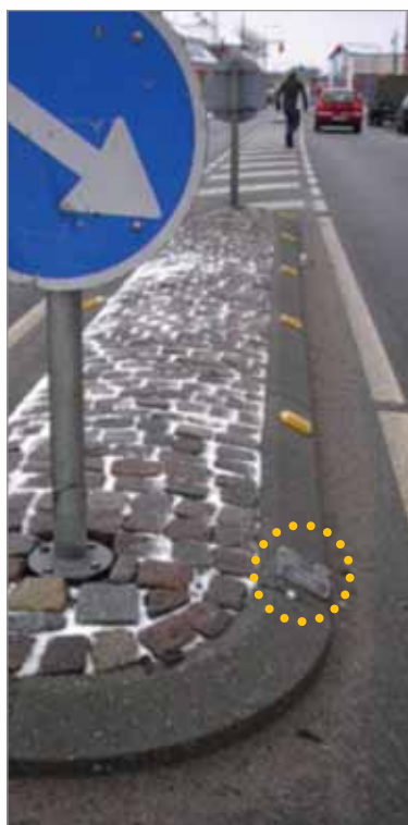
Jislon® T2 markør brugt i kampen for at undgå påkørsler af skilte i Faaborg
